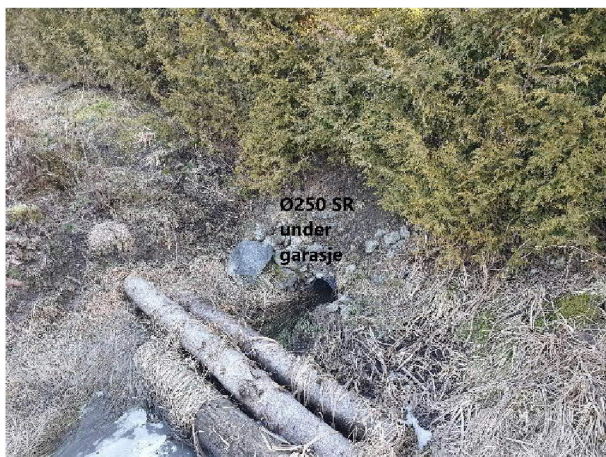
Bilde 3-1: Innløp Ø250 stikkrenne under garasje Åsfaret 6
