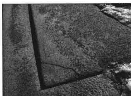
Uriktig utført asfaltskjøt uten fortanning
