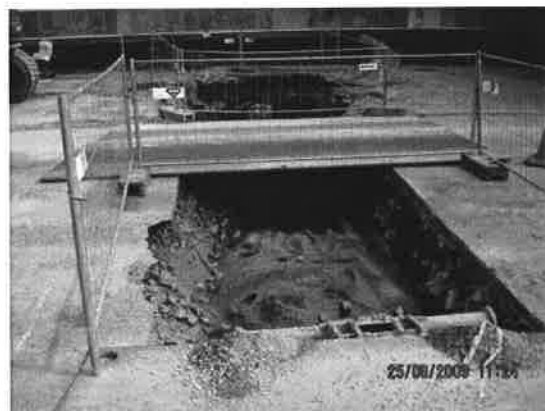
Kjøreplate er ikke frest ned i dekket
